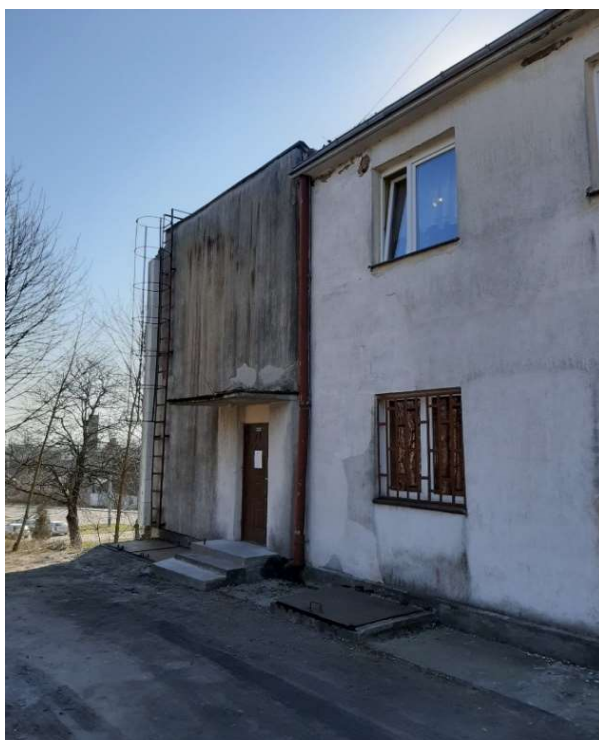
Zdj. 4 Stan przed termomodernizacją
